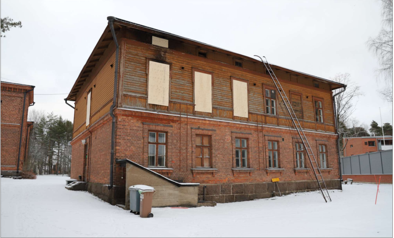
Tulipalon jälkeen osa ikkunoista on peitetty vanerein. Kuvauspäivä 12.12.2019.
